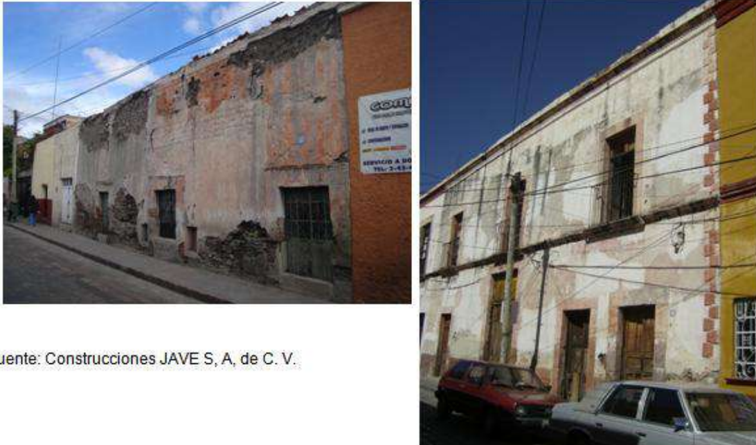
Figura II.25 Ejemplos de inmuebles patrimoniales abandonados y en estado derruido ubicados en: Nicolás Campa Sur No. 55 para la imagen de arriba y Mariano Escobedo No.20 para la de la derecha.
